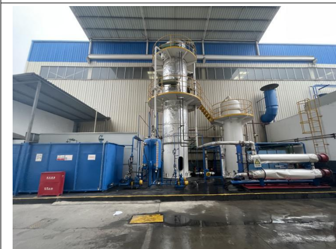
废气处理设施
