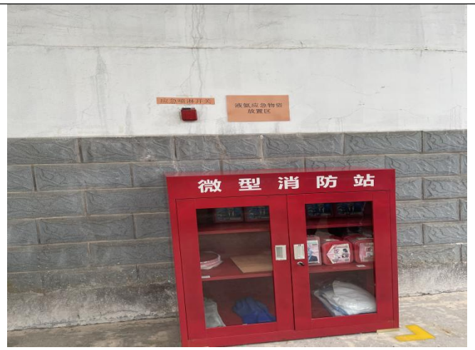
液氨微型消防站
